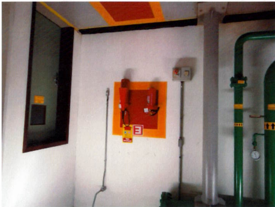
Figura 7 – Vista de extintores Manuais devidamente instalados e sinalizados. Fonte: Arquivo pessoal.
