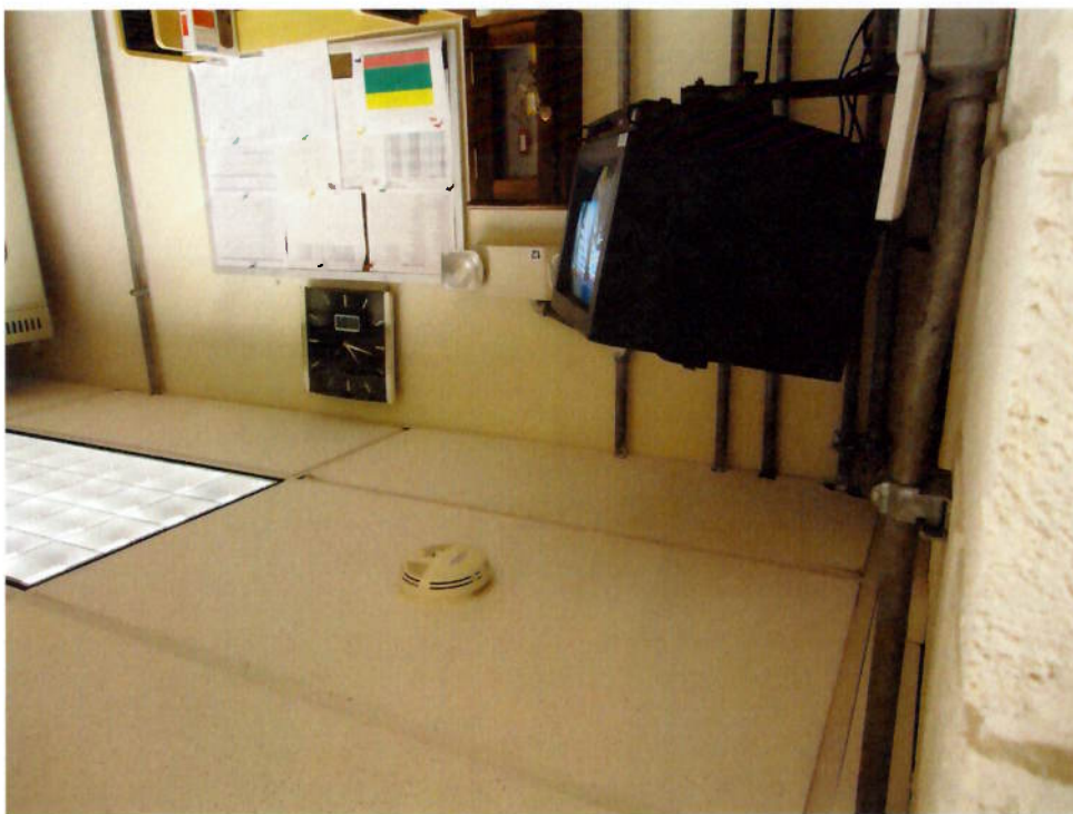
Figura 9 – Vista de um detector de fumaça. Fonte: Arquivo pessoal
