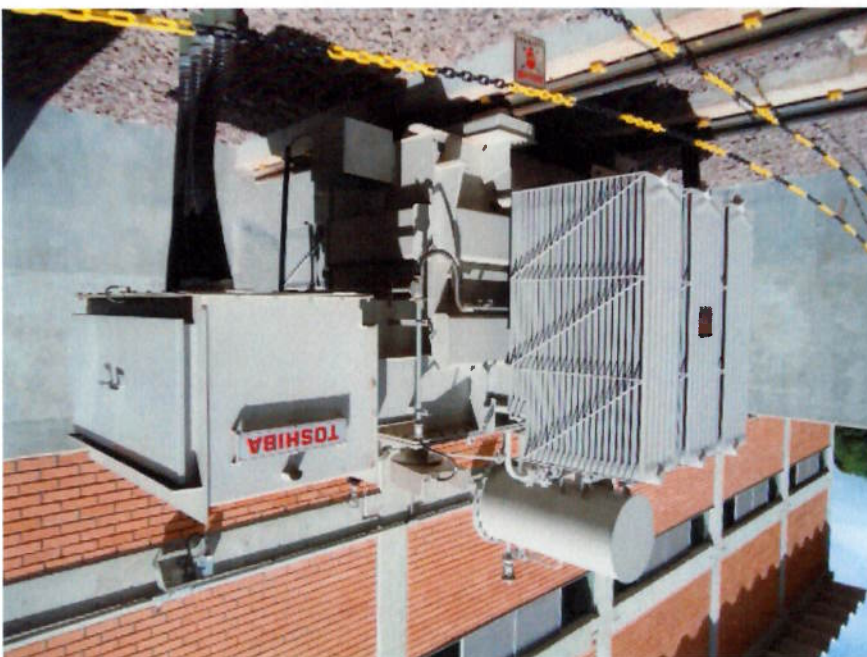
Figura 23 – Vista do transformador elevador. Fonte: Arquivo pessoal
