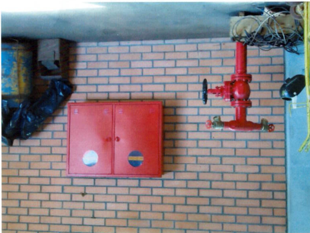
Figura 22 – Ponto de hidrante de saída dupla. Fonte: arquivo pessoal
