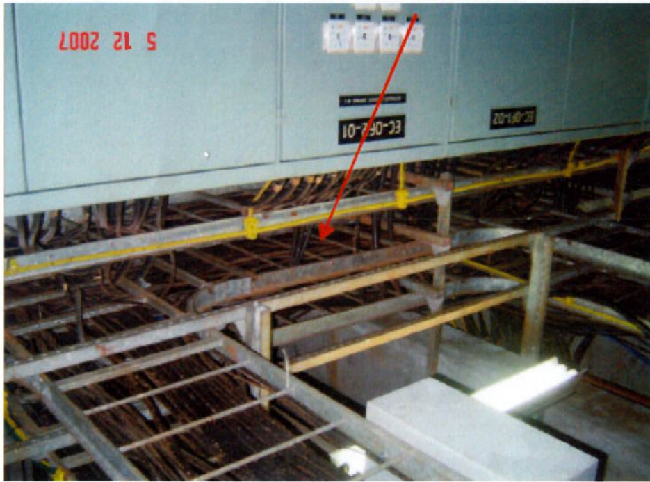
Figura 3— Vista de um típico bandejamento metálico para cabos de comunicação, controle e de força. Fonte: Arquivo pessoal
