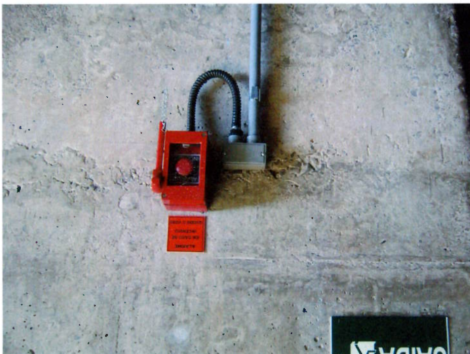
Figura 10 – Vista de uma botoeira do tipo "Quebre o Vidro". (Fonte: Arquivo pessoal)
