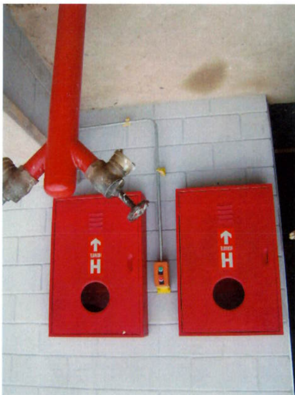
Figura 8 – Vista de um Hidrante de saída dupla. Fonte: Arquivo Pessoal
