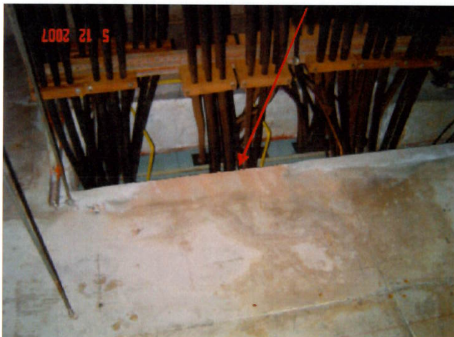
Figura 5 – Vista de uma passagem de cabos vertical.
