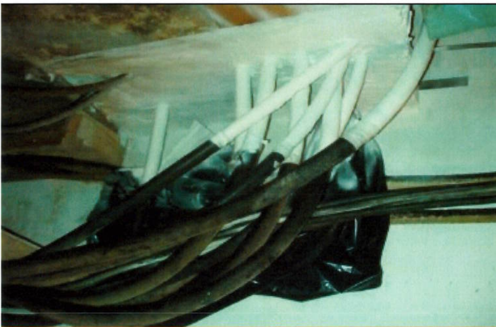
Figura 13– Vista da passagem de cabos com proteção passiva (pintura intumescente). (Fonte: Arquivo pessoal)
