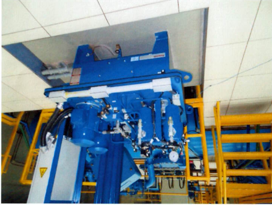
Figura 2 – Vista de um sistema de óleo lubrificante para as turbinas. Fonte: Arquivo pessoal
